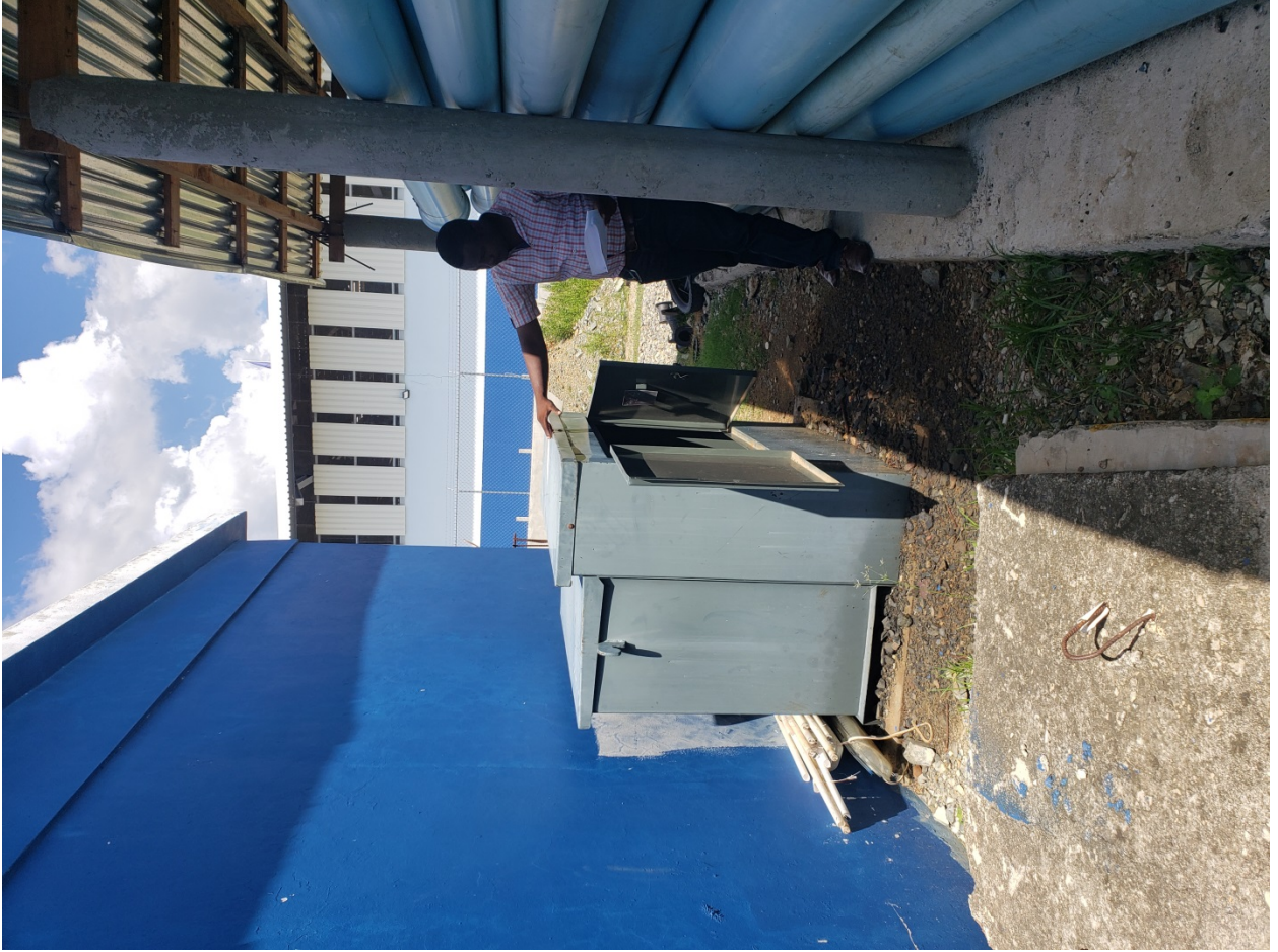
Transformateur triphasé 150 KVA
