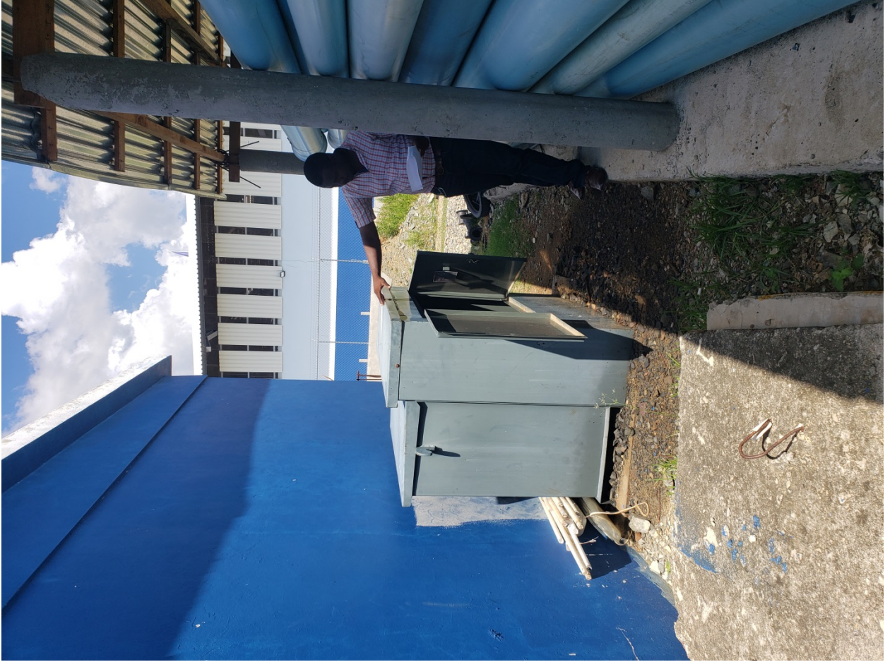
Transformateur triphasé 150 KVA
